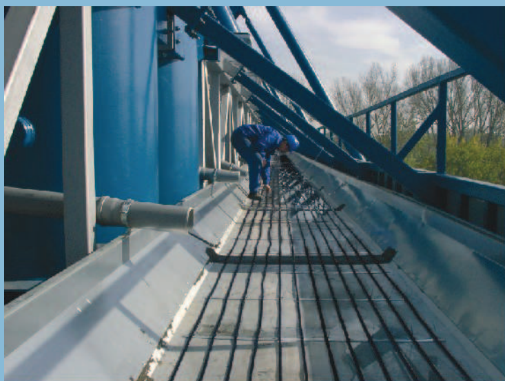
Przykład ułożenia przewodów grzewczych w korycie dachowym
